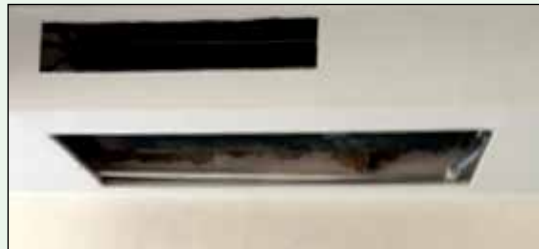
" اجرای سقف کاذب با سینی بلند و نامتناسب بودن دریچه های دسترسی و دهش دستگاه "
