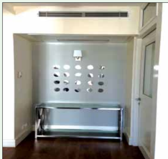
" نصب فن کویل در سقف کاذب با محدودیت فضا و یکسان شدن طول دریچه های دهش و مکش "
