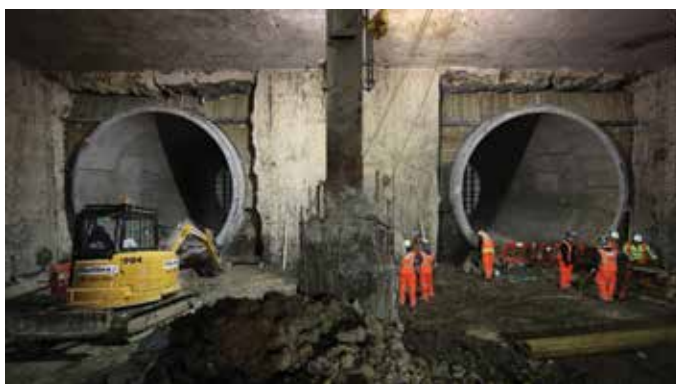
▲ کارروی پروژه در سال ۲۰۰۹ در منطقه داکلند در شرق لندن از اسکله قطاری آغاز شد. این به معنی توسعه بعضی از مشهورترین ایستگاه‌های شهر لندن مانند این ایستگاه (پارینگتون) می‌باشد.
