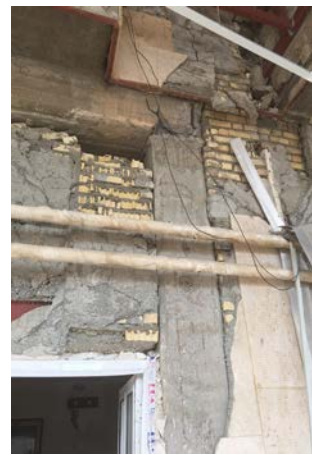
تصویر ۱: گسیختگی اتصال ستون و تیر در بیمارستان شهیدا - سرپل ذهاب
