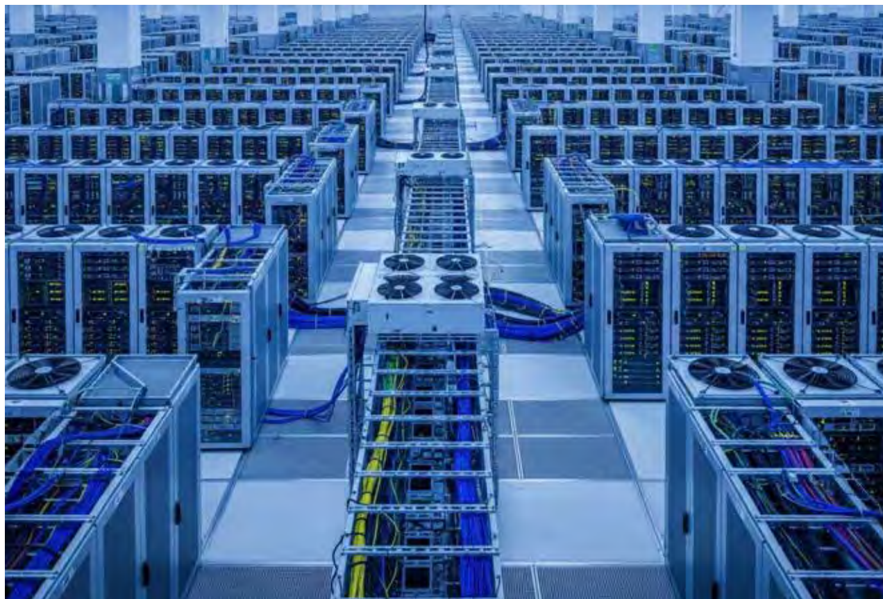
داخل یک مرکز داده (Data Center)
